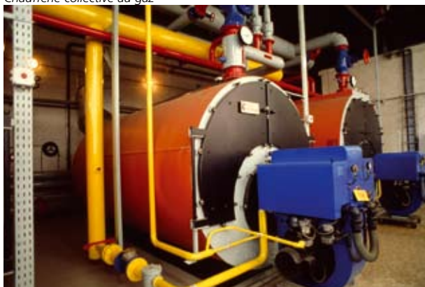
Chaufferie collective au gaz
