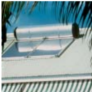
Dans un CESI monobloc, le ballon de stockage est situé à l'extérieur, au-dessus des capteurs : on le déconseillera donc dans des régions au climat rigoureux.
